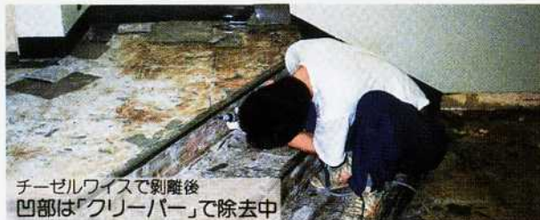
階段の垂直面も、途中から喰い込ませバリバリ剥離するチーゼルワイス
